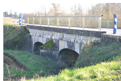
Fig. 15 - Pont sur le ruisseau de Lahontan à Mascara, vue depuis le nord-est.
