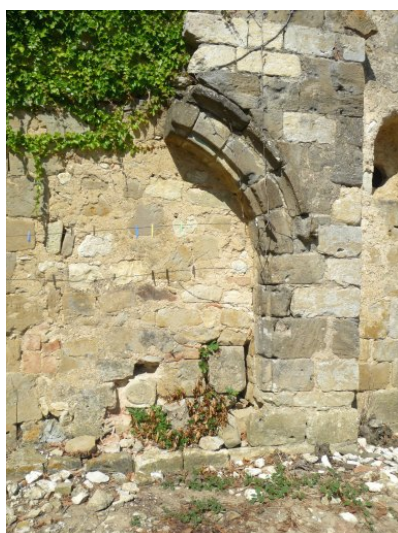
Fig. 8 - Vestige d'un enfeu sur le mur Sud.
